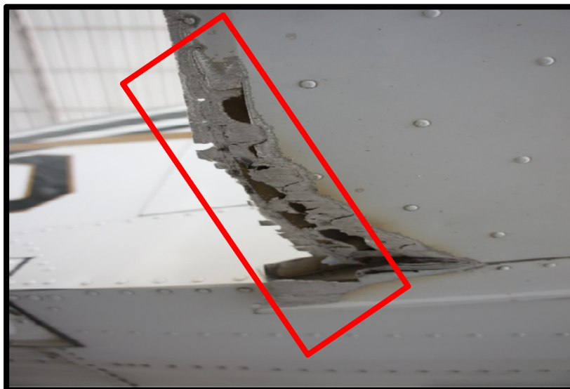
Fotografía No. 15 Vista de daños en flap derecho.
